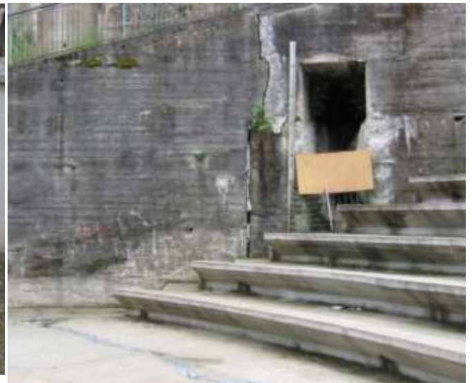
Fig.17 – Fratture nei muri di sostegno realizzati a protezione dell'anfiteatro.
