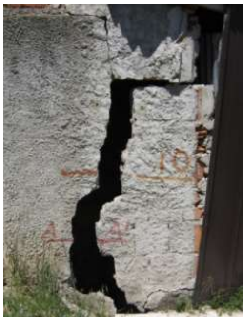
Fig.18 –Particolare di frattura con apertura maggiore di 10 cm su edificio adiacente la ex-scuola media.
