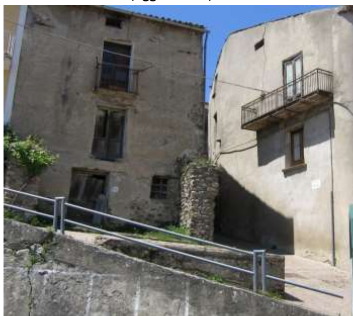
Fig.20 –Fratture presenti sulle mura degli edifici e sulle opere di contenimento del centro storico di San Martino di Finita.
