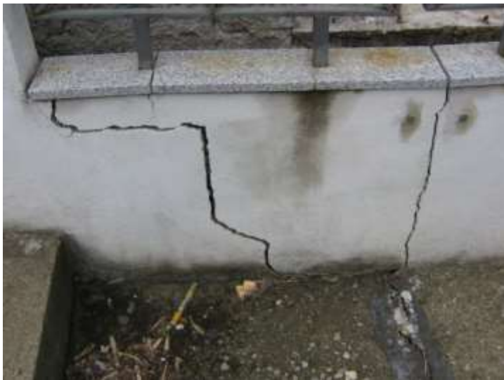
Fig.16–Lesioni al muretto di recinzione di abitazione privata adiacente ad anfiteatro.
