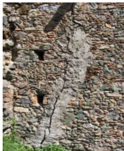
Fig.21 – Esempio di frattura di neoformazione che attraversa l'intonaco di recente fattura di un antico manufatto adibito a magazzino.
