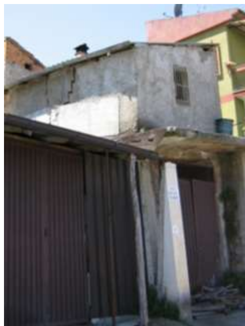
Fig.19 –Diffuse fratture che evidenziano apertura fino a 50 cm su pilastro di edificio adiacente la ex-scuola media.
