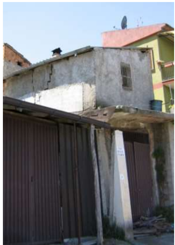
Fig.19 –Diffuse fratture che evidenziano apertura fino a 50 cm su pilastro di edificio adiacente la ex-scuola media.
