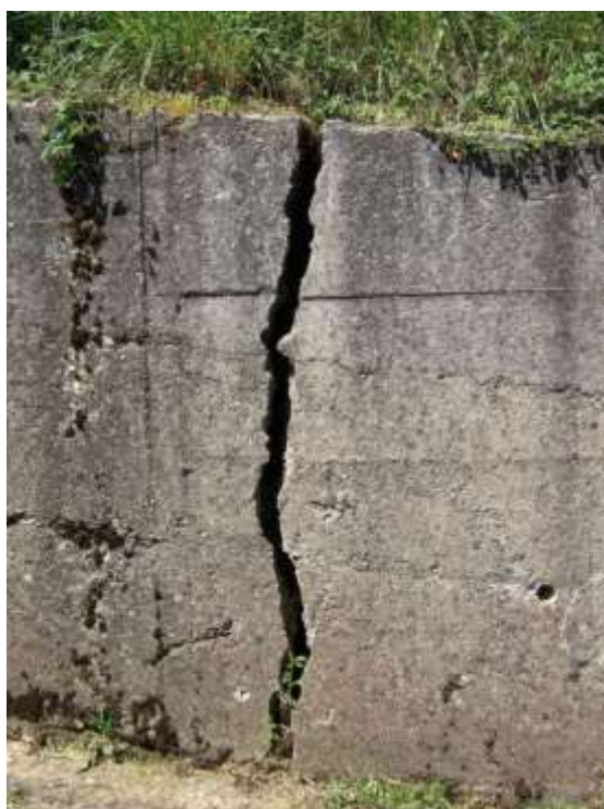
Fig.14 –Frattura su un'opera di contenimento situata a monte dell'edificio comunale di San Martino di Finita
