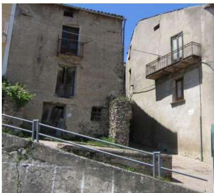
Fig.21 –Fratture presenti sulle mura degli edifici e sulle opere di contenimento del centro storico di San Martino di Finita.
