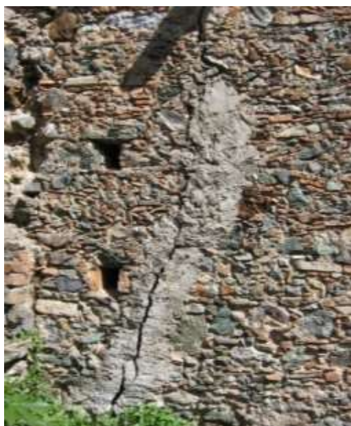
Fig.20 – Esempio di frattura di neoformazione che attraversa l’intonaco di recente fattura di un antico manufatto adibito a magazzino.
