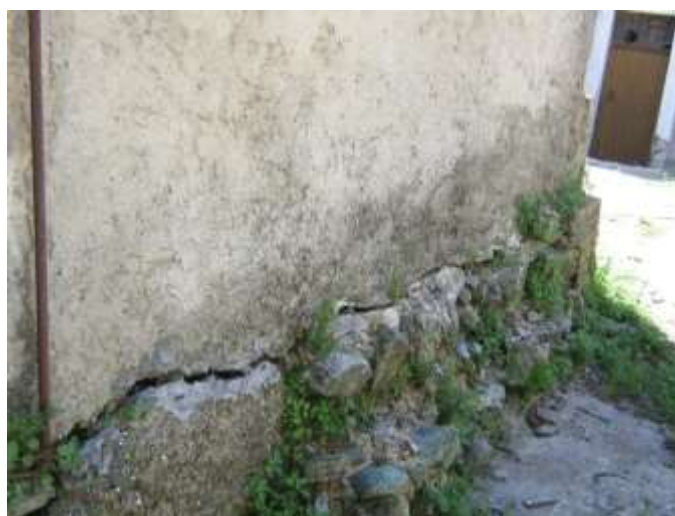
Fig.15 –frattura sub-orizzontale che interessa la base di un edificio privato.
