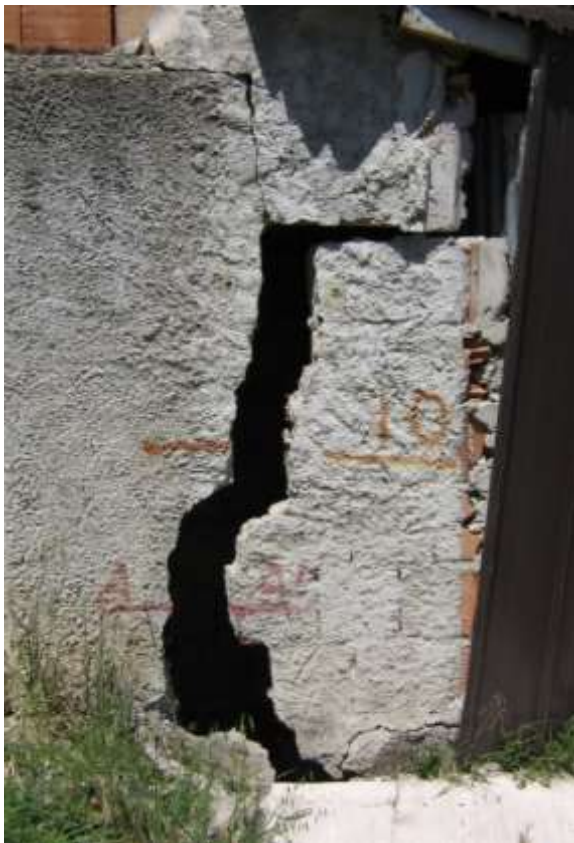
Fig.18 –Particolare di frattura con apertura maggiore di 10 cm su edificio adiacente la ex-scuola media.
