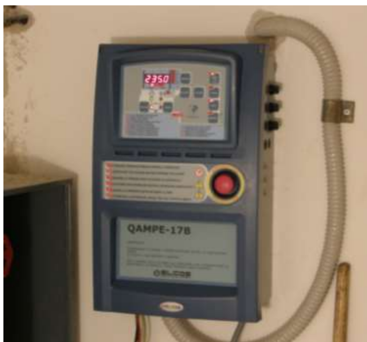
Fig. 17– Gruppo elettrogeno automatico e quadro di comando allocati all'interno del C.E.D.
